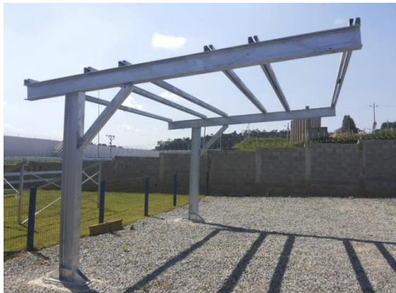
Figura 10: Exemplo de estruturas de fixação para estacionamento Fonte: Foto tirado da empresa Politec
